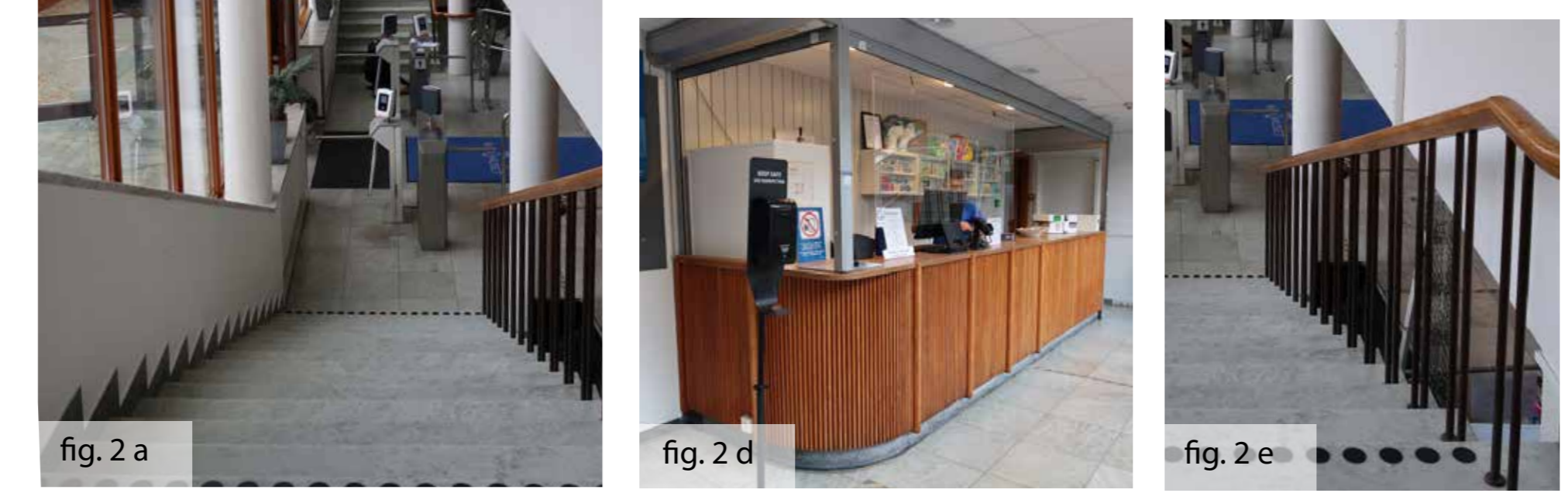
Fig. 2 - q. Skyddsbestämmelser för badhuset, interiört, anger att rummets volym (fig. 2 a), trappor av marmor och smidesräcken med handledare (fig. 2 e) ska bevaras, liksom ursprungligt golv (fig. 2 a, d och e), fönsterbänkar av marmor (fig. 2 c), innerdörrar (fig. 2 b) väggreliefer (fig. 2 a), kassans placering och utförande (fig. 2 d) och invändigt fönsterparti mot simhall (fig. 2 a).
