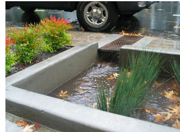
Inlopp i anslutning till dagvattenmagasin i gatumiljö.
